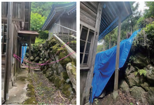
常態か緊急措置なのかの状況説明がない景観を損なう処理(下宮)
