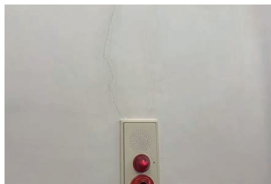
ひび割れた壁
