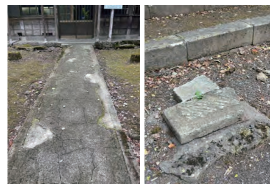
割れた舗装、崩れた敷石 (下宮)
