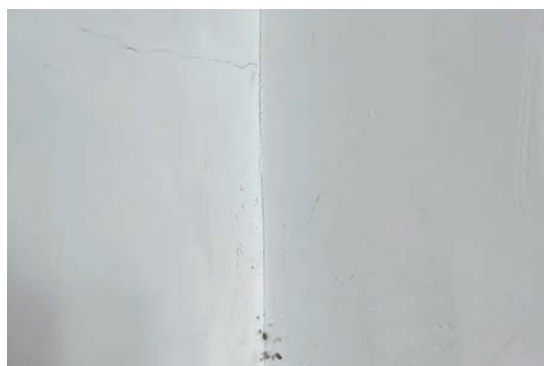
1F廊下のひび割れ、シミの浮き出た壁
