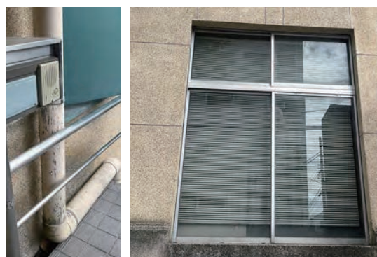
塗装のはげた玄関脇の雨どい、 棧のゆがんだ建物正面から見えるブラインド
