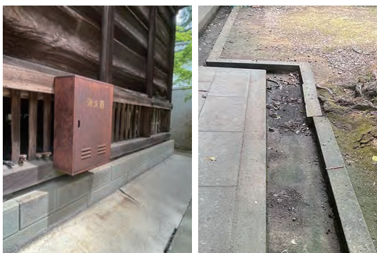
色味がそぐわない上に錆びた消火器BOX、 崩れかかった排水路 (下宮)
